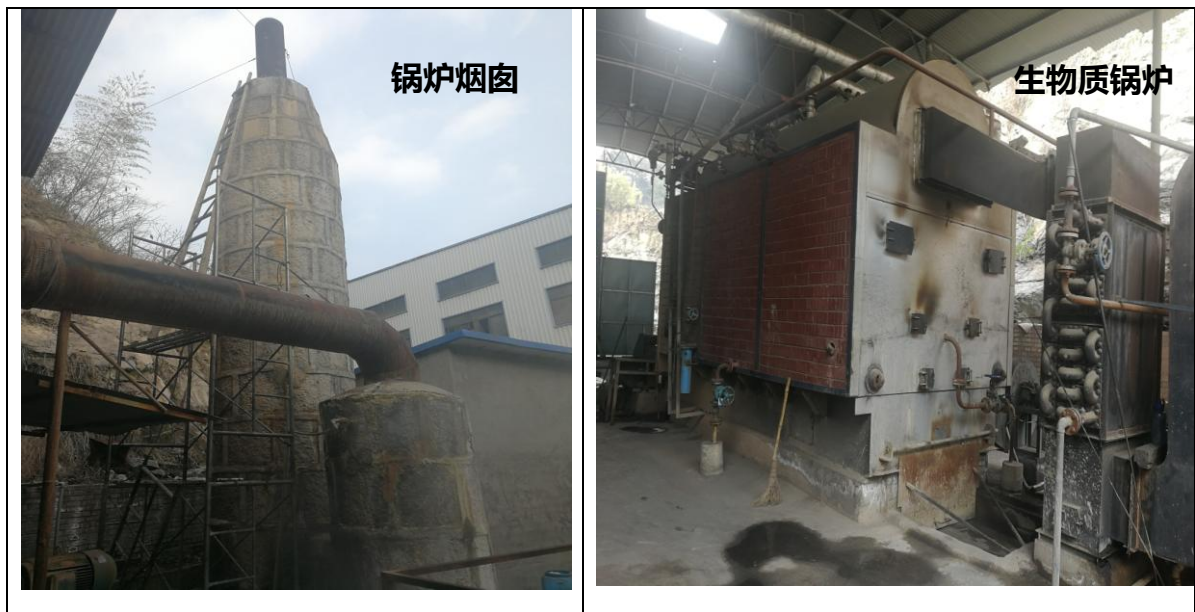
图 4-4 企业废气治理现场相关照片
