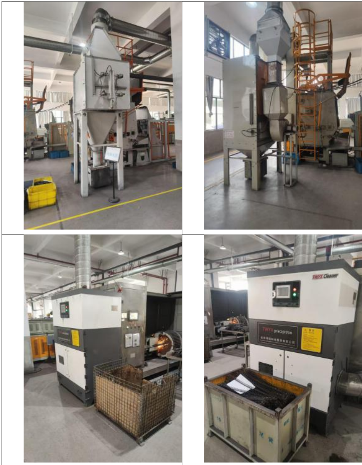
图 3-7 抛丸、磨簧废气处理设施现场图
