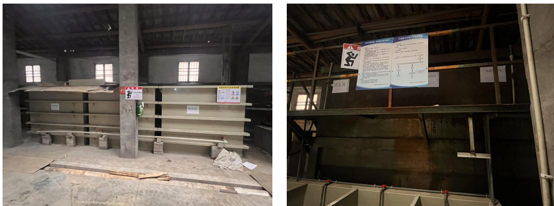
图 3-3 废水处理现场图
