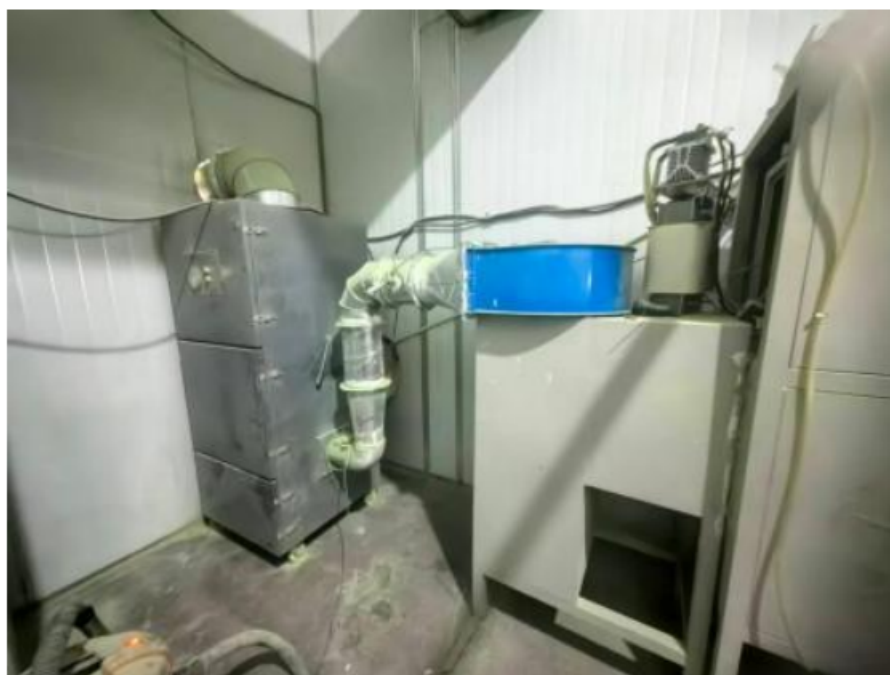
图 3-7 浸塑废气处理现场图
