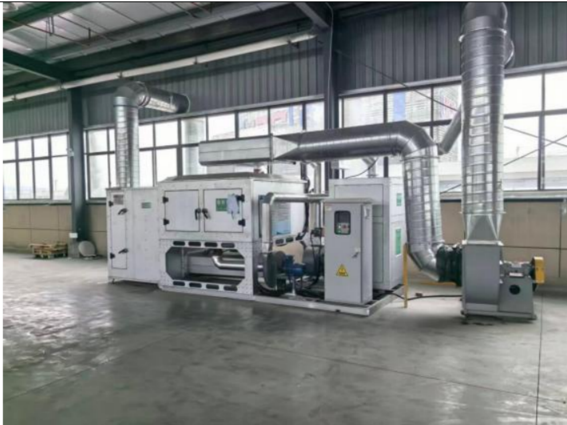
图 3-5 滴漆、浸漆、浸塑、固化废气处理现场图
