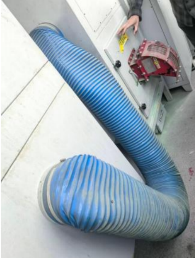
图 3-6 浸塑废气处理现场图
