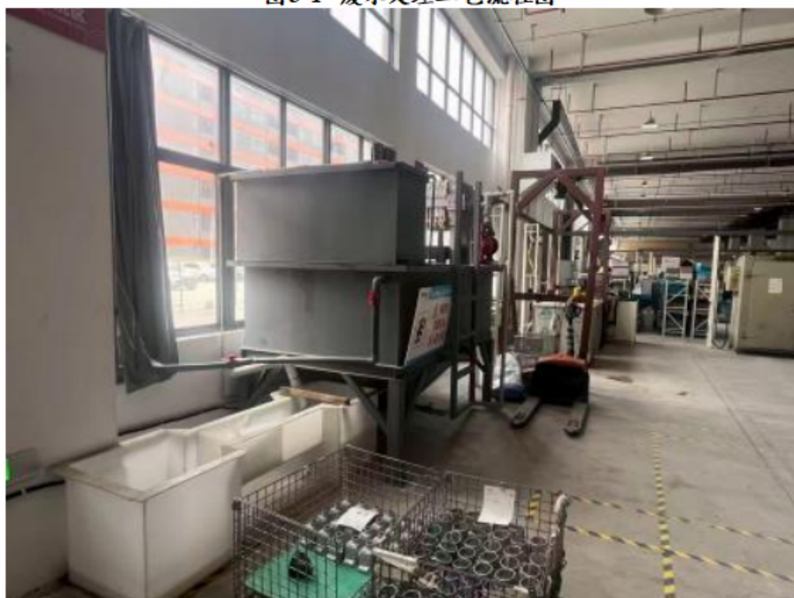
图3-2 污水处理站现场照片
