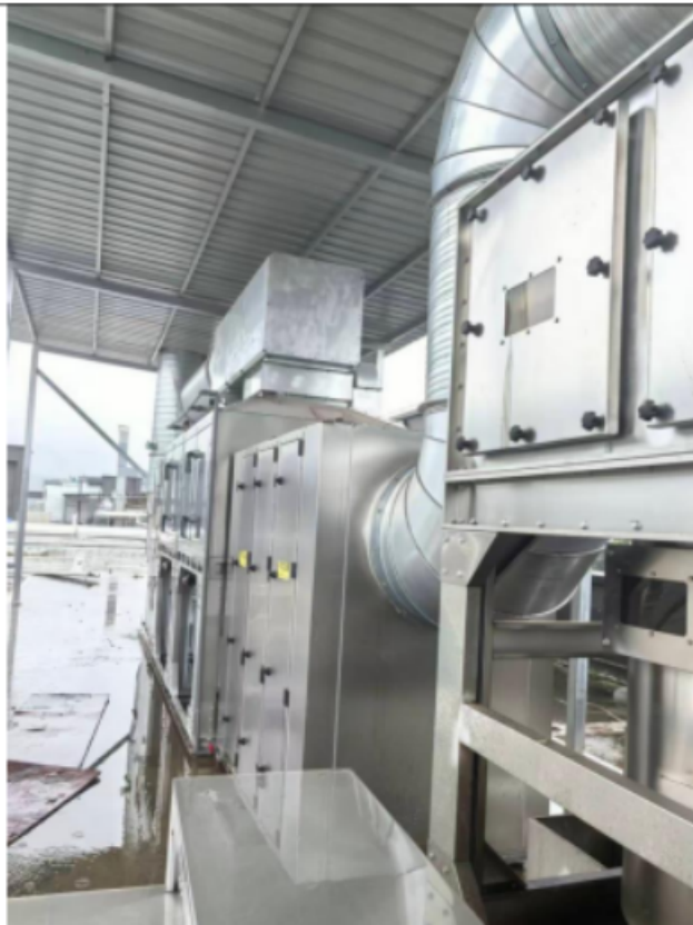
图 3-4 滴漆、浸漆、烘干、浸塑、固化废气处理现场图 浸塑废气经布袋除尘处理后通过 28m 的排气筒排放。
